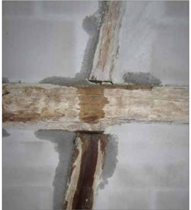
Nahaufnahme: Der Schlagregen drückt sich durch alle Fugen
