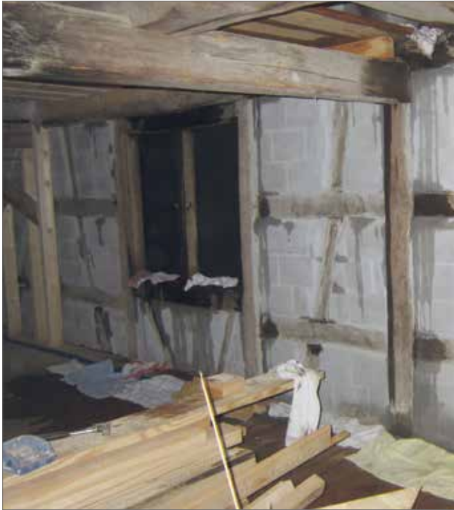
Schlagregen auf der Innenseite einer Riegelwand.
