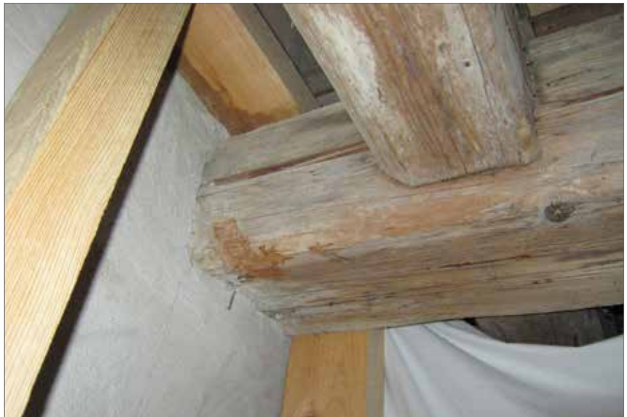
Balkenkopf mit Riss: Riss in Balkenköpfen können eine Leckage darstellen
