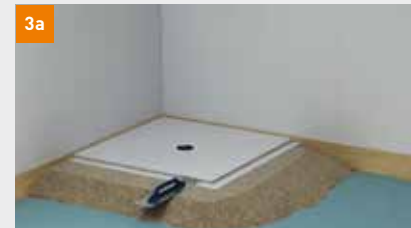
Variante A: Um das Duschelement wird in Höhe des überstehenden Falzes ein ca. 200 mm breiter Damm geschüttet – als Auflage für das Abziehen der restlichen Fläche
