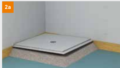
Variante A: In der Höhe der Oberkante des Ablaufgehäuses wird im Bereich des Duschelements die gebundene Schüttung abgezogen und das Duschelement gesetzt
