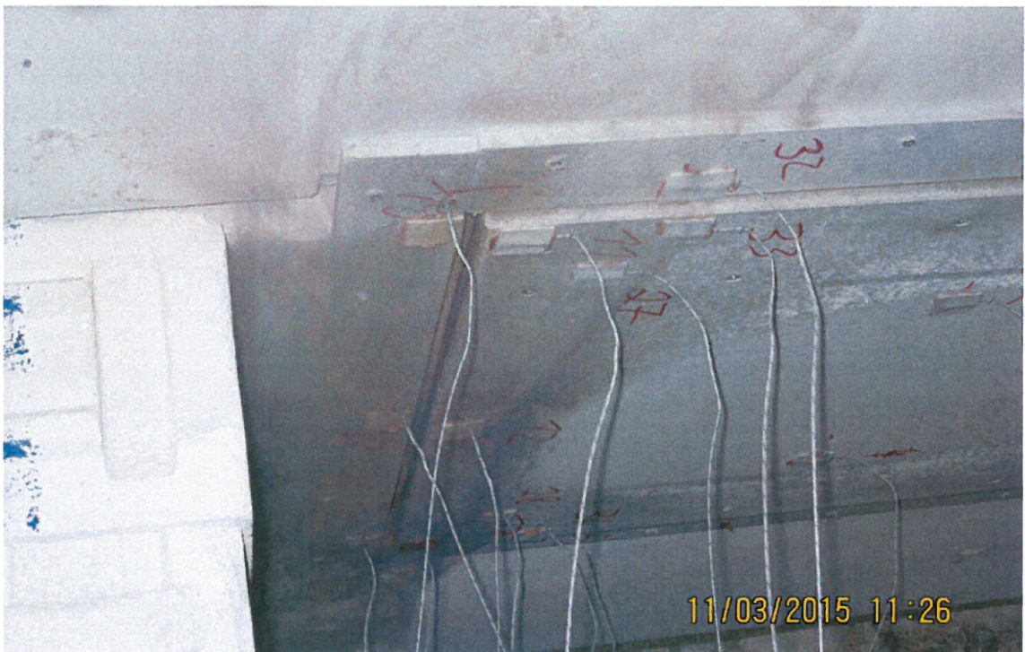
26. Minute: Die Klappe verformt sich im Scharnierbereich ca. 10 mm nach unten
